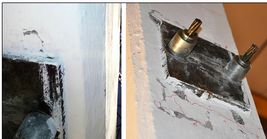
Figura 3. Falla de anclaje en armadura longitudinal, deslizamiento de armadura de disipación.
