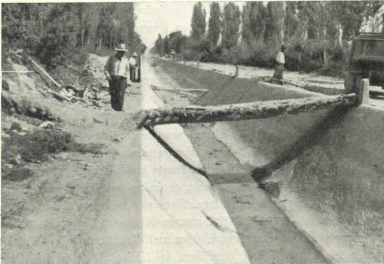
FOT. 2 - Canal de defensa construido en el departamento de San Carlos, cerca de La Consulta.
