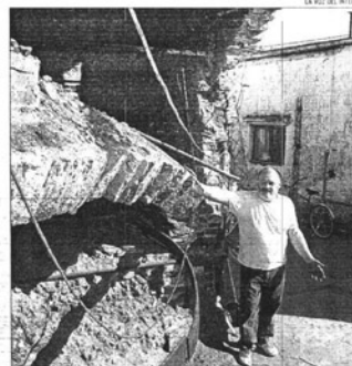
En la panadería de Alfredo Moiso se derrumbó el horno de pan.
