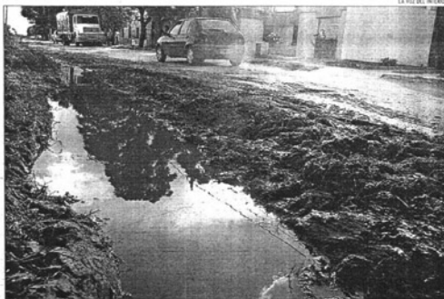
En el sur de Coronel Moldes los pozos colapsan y el agua servida sale a la cuneta.
